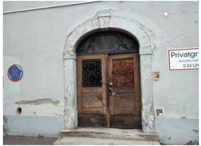
Eingang Puch-Direktorenwohnhaus, 17. Jh. (Abriss genehmigt)
